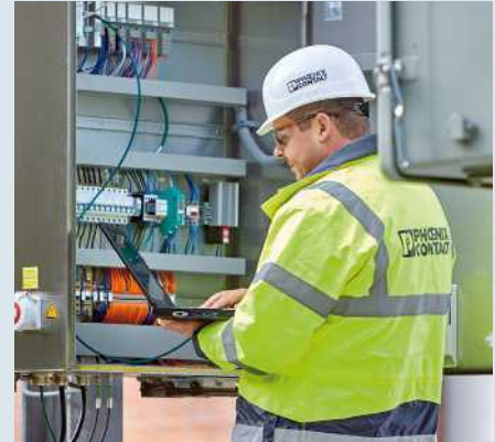
Einsatz des Fernwirk- und Automatisierungssystems im Energienetz
