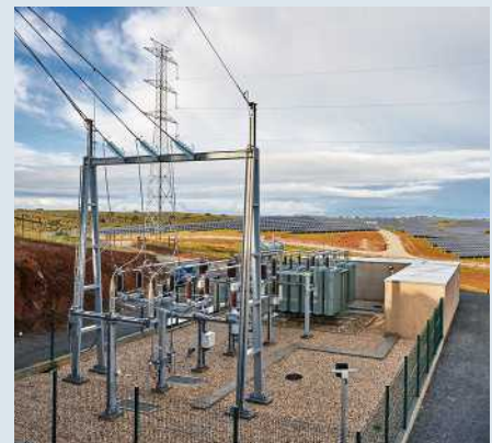
Netzanschluss mit der Einspeiseregulierung von Phoenix Contact im PV-Kraftwerk
